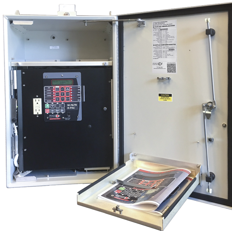
Figura 3 Gabinete de control de recierre M-2979
